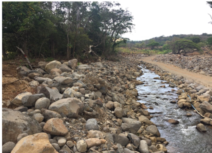
Fotografía #9 Dragado y dique del río Cuipilapa en colindancia norte de la finca
