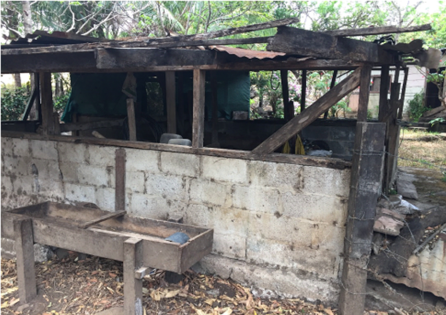
Fotografía # 16 Vista del chiquero abandonado
